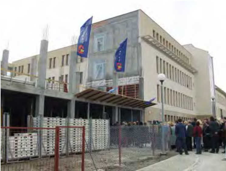
Fundamenty Instytutu Geografii i Gospodarki Przestrzennej UJ przylegające do wybudowanej części Kompleksu Nauk Biologicznych; październik 2003
