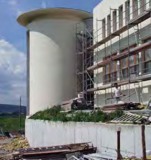
Narozny fragment gmachu obecnego Wydziału Biochemii, Biofizyki i Biotechnologii w budowie; czerwiec 2001
